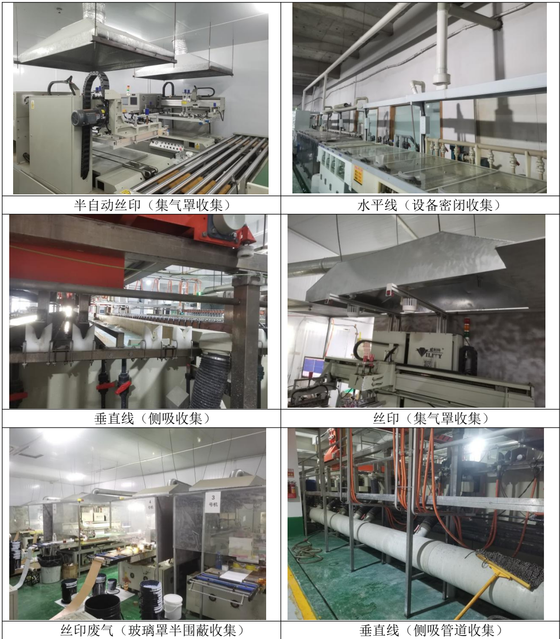
图 2.14-24 现有项目废气收集现状照片
