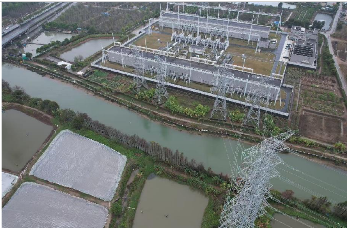
500 千伏文山站扩建间隔侧
