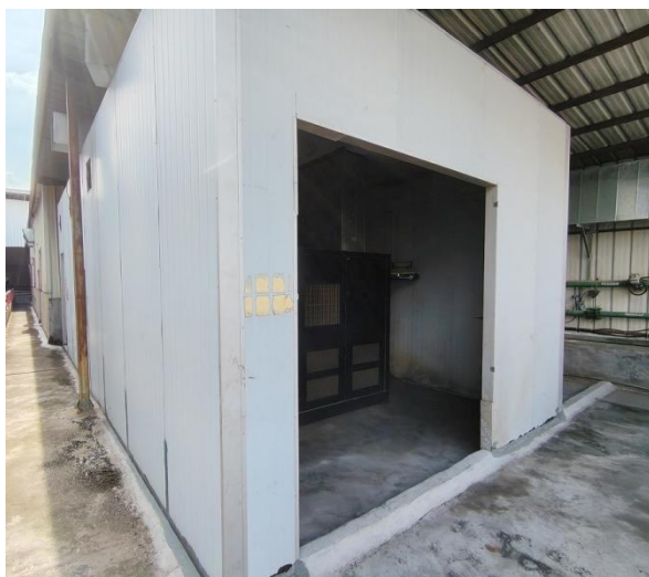
附图 3 空压机房现场图
